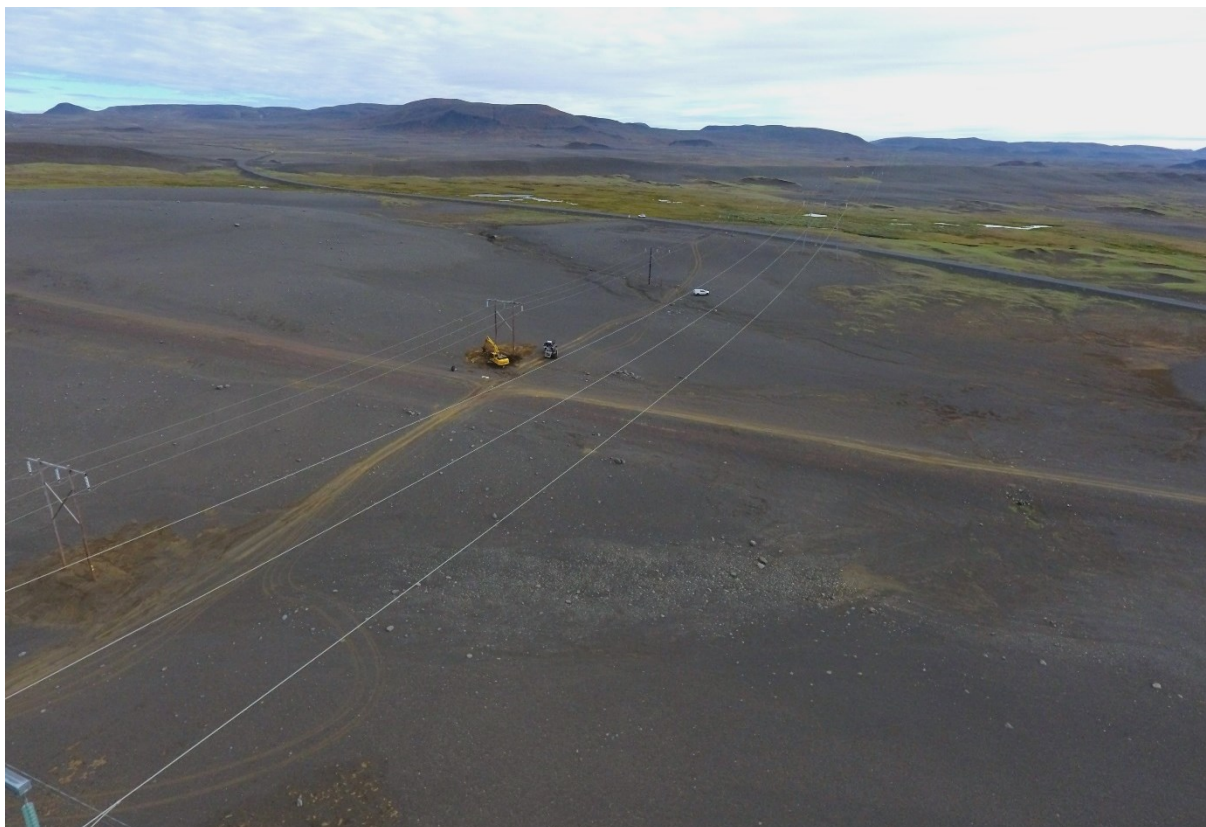
MYND 4.2 KR3 við Þjóðveg 1 austan Vegaskarðs. Sýnilegt rask er einkum vegslóðar í sandinum, mjög lítið rask er við möstur. Þegar myndin var tekin var unnið að viðhaldi á Kröflulínu 2.
