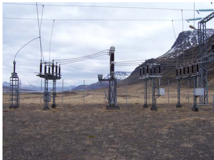
Mynd 8. Tengivirki Stuðlum – Eskifjarðarlína 66 kV.
