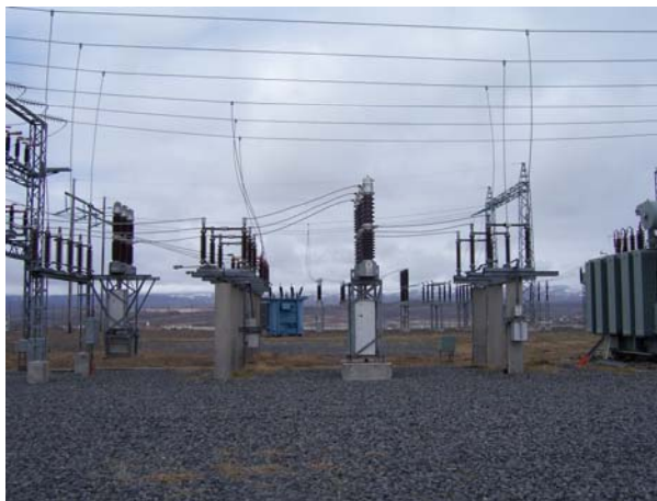
Mynd 4. Tengivirki Eyvindará – Eskifjarðarlína 66kV. Hugsanlegt svæði undir nýjan 132 kV tein og rofareiti fyrir 132 kV tengingu til Eskifjarðar.
