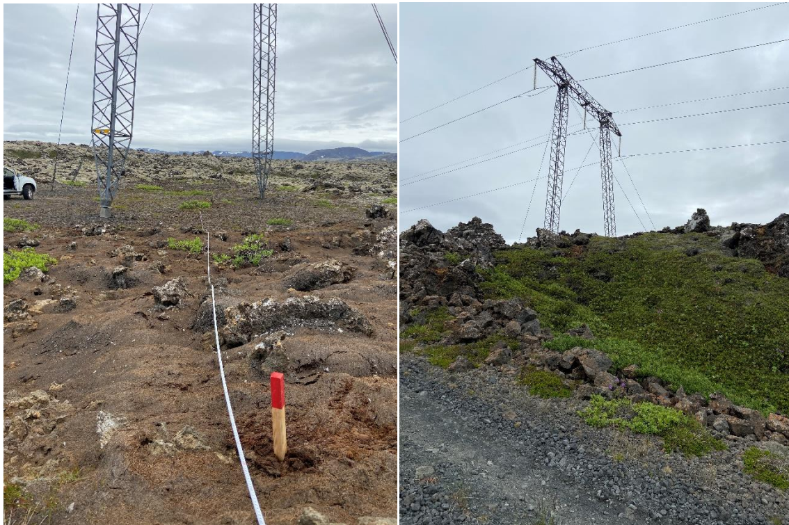
Mynd 5 Vinstra megin sést brunninn mosi við mastur 277 á Búrfellslínu 3B sem liggur upp á hæð. Hægra megin sést að litlar gróðurskemmdir eru neðan við hæðina.
